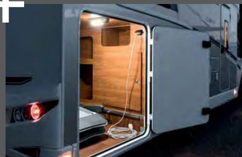
Verlichting en 230V-stopcontact in de garage
