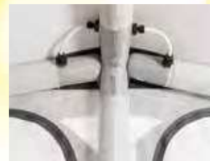
Verbinding tussen de luchtslangen
